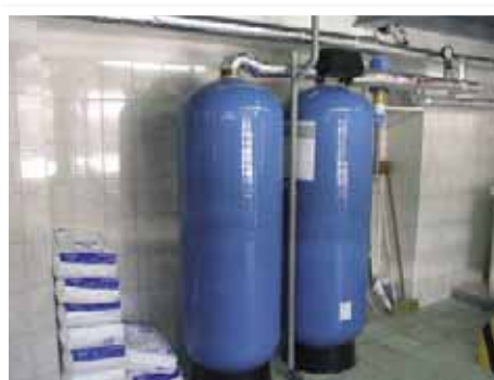
Kondenzátní hospodářství – kondenzátní nádrž (2 × 5,5 tun páry/hod)
